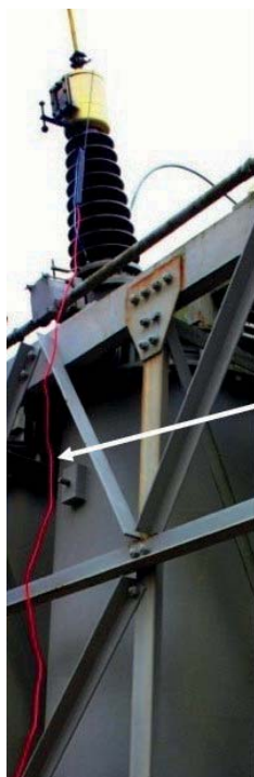
Cablu ecranat coborând prin laterala unui transformator de putere către instrumentul de măsură
